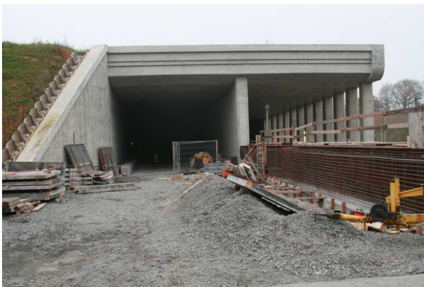
Tunneleingang mit aus Brandschutz- gründen nachträg- lich zu erstellender Trennwand
