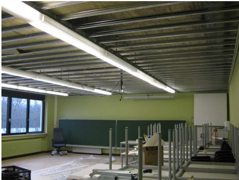
Bild 3 – Baustelle Klassenzimmer: In die Bandraster eingehängte Unterkonstruktion zur Aufnahme der GK-Lochplattendecke – die Beleuchtung musste nicht demontiert werden
